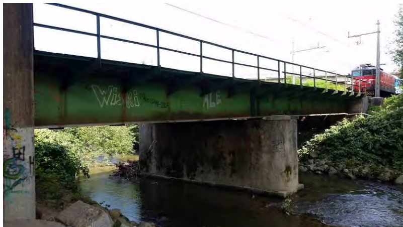
Most Mali Graben, spodaj vodotok. Levo se vidi del stebra nadvoza, ki je preblizu mosta.
